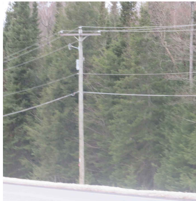
3 EXISTING POWER POLE/ TRANSFORMER SCALE: N.T.S.
